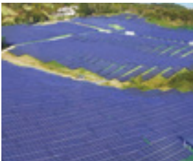
S-11 高崎太陽光発電所B
