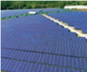
S-05 鉾田太陽光発電所
