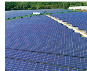
S-05 鉾田太陽光発電所
