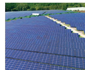
S-05 鉾田太陽光発電所
