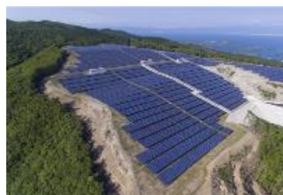
S-06 長崎琴海太陽光発電所
