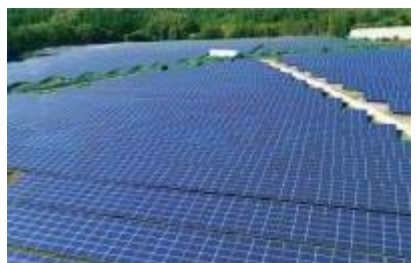
S-05 鉾田太陽光発電所
