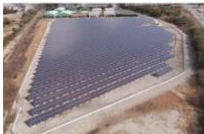
S-03 JEN防府太陽光発電所
