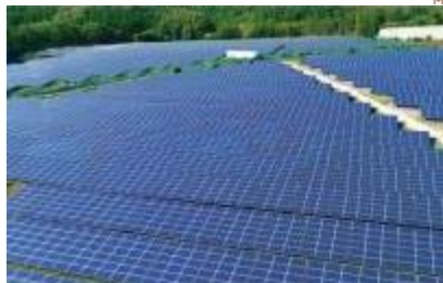
S-05 鉾田太陽光発電所
