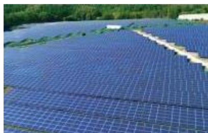
S-05 鉾田太陽光発電所
